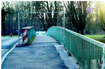
Die Brücke über den Decksteiner Weiher weist Schäden auf. Deshalb ist die nördliche Seite der Brücke weiterhin gesperrt. BILD: EICKLER
